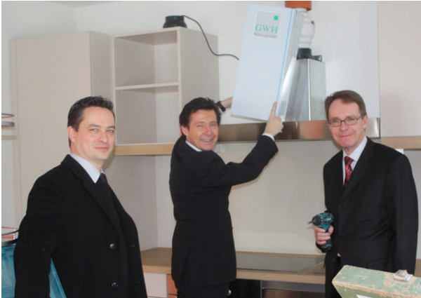
Architekt Friedhelm Schmidt, GWH-Geschäftsstellenleiter Stefan Bürger und Dr. Jürgen Barthel (Leiter des Dezernats für Finanzen, Beteiligung und Soziales) montieren letzte Teile in der Küche der Demenzwohngemeinschaft
